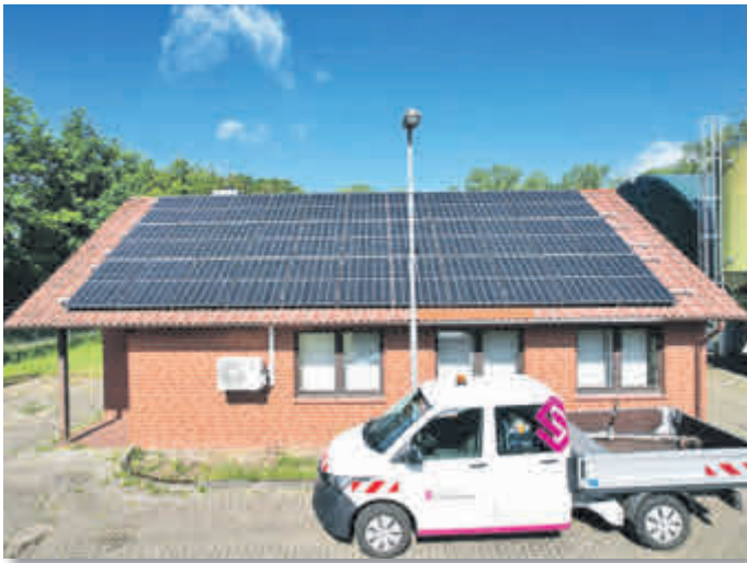
Photovoltaik-Anlagen liefern jetzt Sonnenstrom vom Dach der Kläranlagen in Neuenkirchen (Bild) und Schneverdingen. Quelle: Heidjers Stadtwerke
