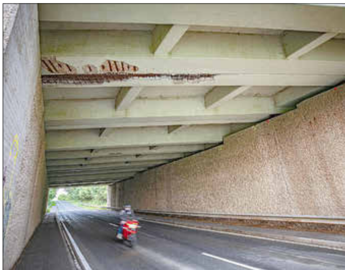
Schäden: Deutliche Schäden am Beton waren zuletzt an der A3-Unterführungen zwischen Nentershausen und Eppenrod, wie hier an der Decke zu erkennen. Nun will die Autobahn GmbH für rund 250.000 Euro die Schäden von einer Fachfirma beseitigen lassen
