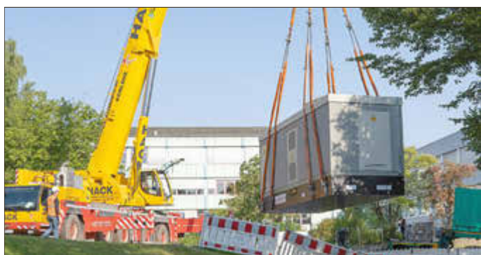
Kurz vor Ende der Ferien wurde die neue Trafostation im Schulzentrum Montabaur angeliefert.
