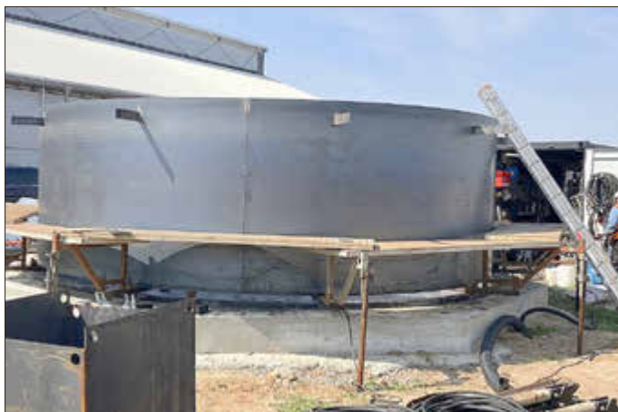
Aufbau des Pufferspeichers auf dem Gelände der Heizzentrale
