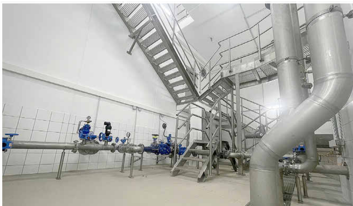
Der Hochbehälter in Hohensayn ist mit moderner Technik ausgestattet.
