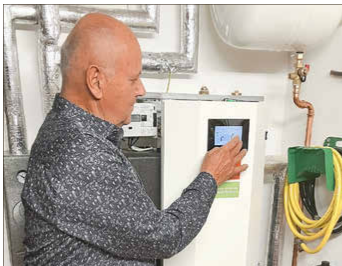
Jürgen Kohle vor der neuen Übergabestation, die den hauseigenen Heizkreislauf mit dem Nahwärmenetz verbindet.
