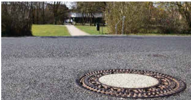
Über den Regenwasserkanal im Altfeldweg in Euerbach wird das Oberflächenwasser aus dem Baugebiet Steigholz in ein Regenrückhaltebecken unter der Schäferswiese geleitet.
