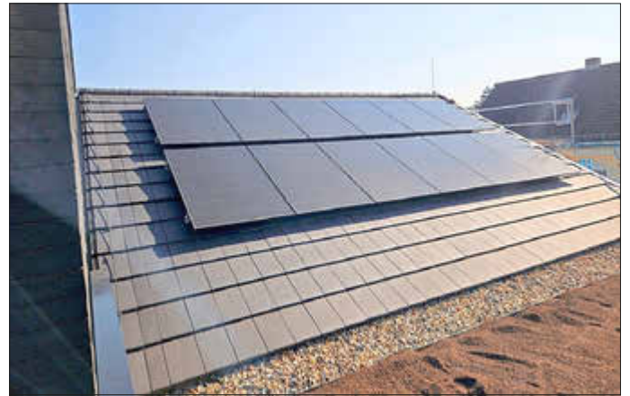
PV-Anlage der Bürger Energie Kassel & Söhre eG (Bildquelle: KAS Elektrotechnik GmbH)
