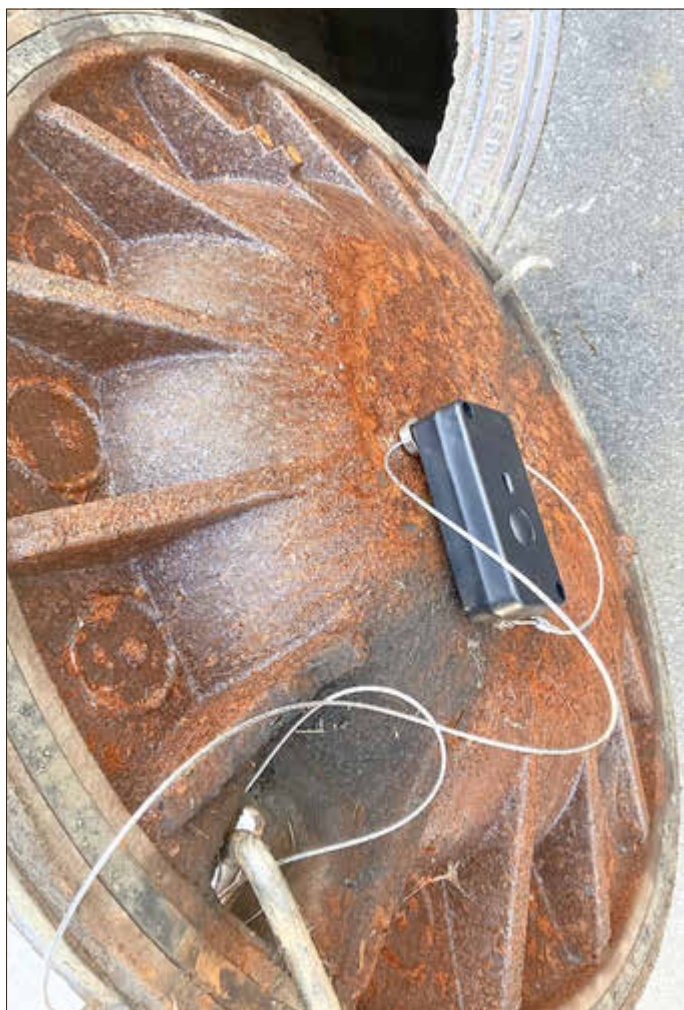
Ein Sensor an einem Kanaldeckel, der Abflussmengen misst. Foto: Landkreis Fulda
