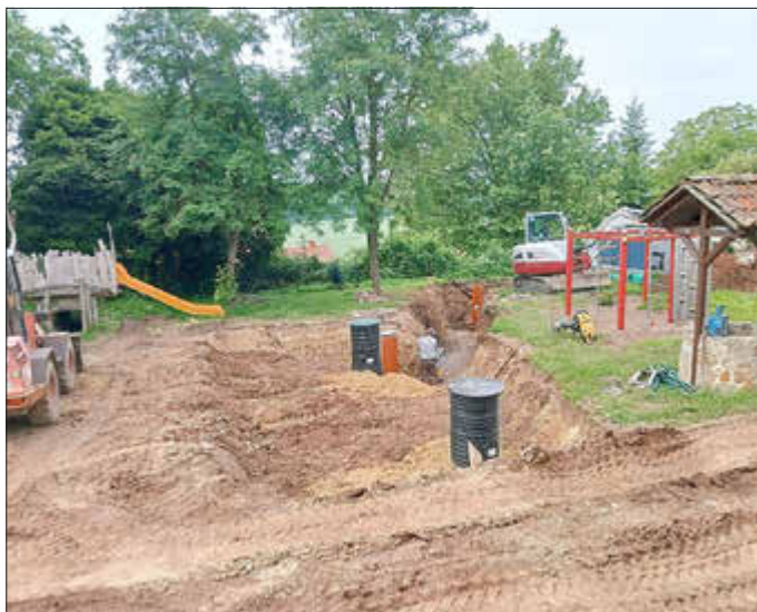
Um das in erheblichem Maße auftretende Schichtenwasser ab- fangen und ableiten zu können, mussten ganz erhebliche Erdar- beiten durchgeführt werden, die auch den Scherbdaer Spielplatz betrafen. Fotos: R. Lämmerhirt
