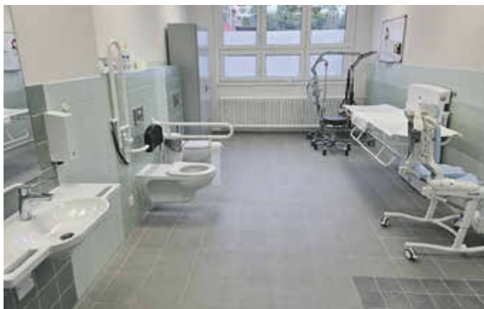
Die neuen sanitären Anlagen entsprechen den besonderen Anforderungen der Schule. (Foto: Landratsamt Wartburgkreis)
