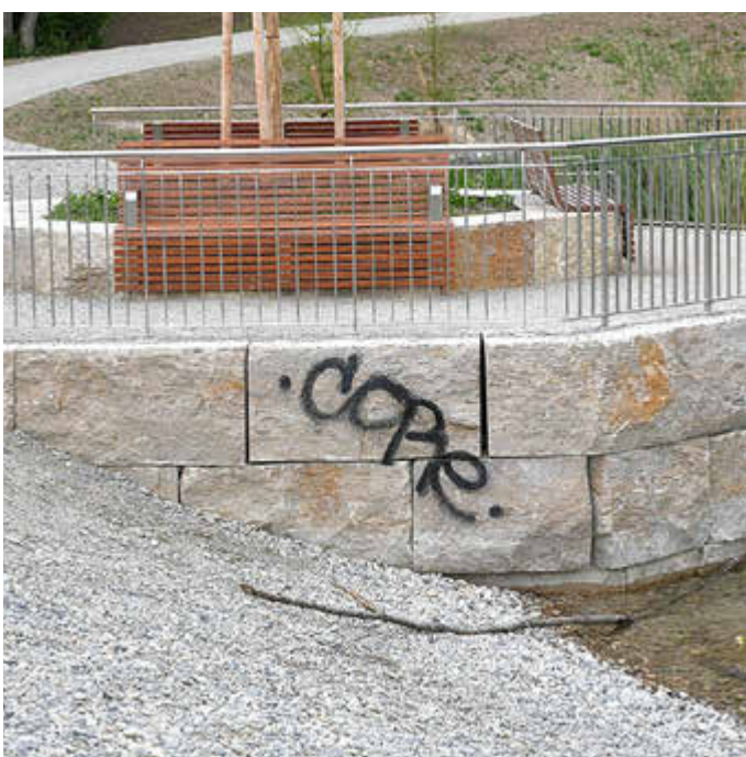
An vielen Stellen wurden Graffiti-Tags aufgesprüht. Diese können nicht mehr vollständig beseitigt werden.
