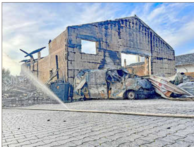
Von der Zimmerei blieb eine Ruine.
