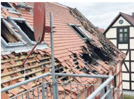
Das völlig zerstörte Dach des Kulturspeichers, Foto: HAFFmedia
