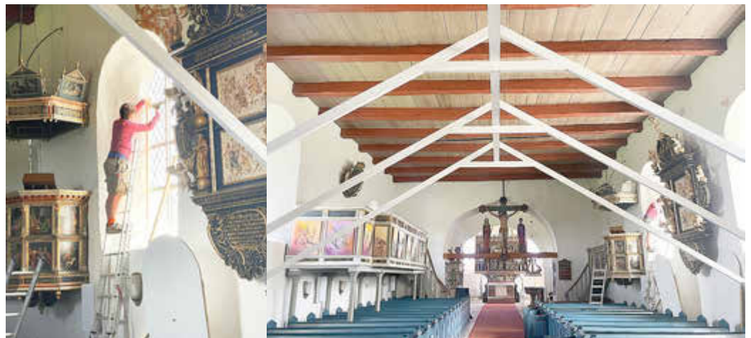
Einbau einer Verdunklung für die Fenster und einer Dachkonstruktion für die Projektionsleinwand.
