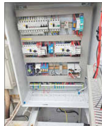
Stromkasten Klärwerk durch Dirk Tempel
